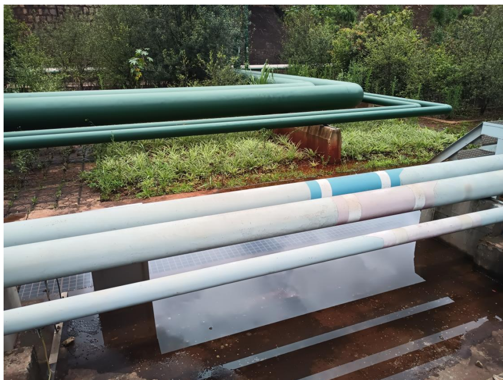
图 2-7 油品输送管道
