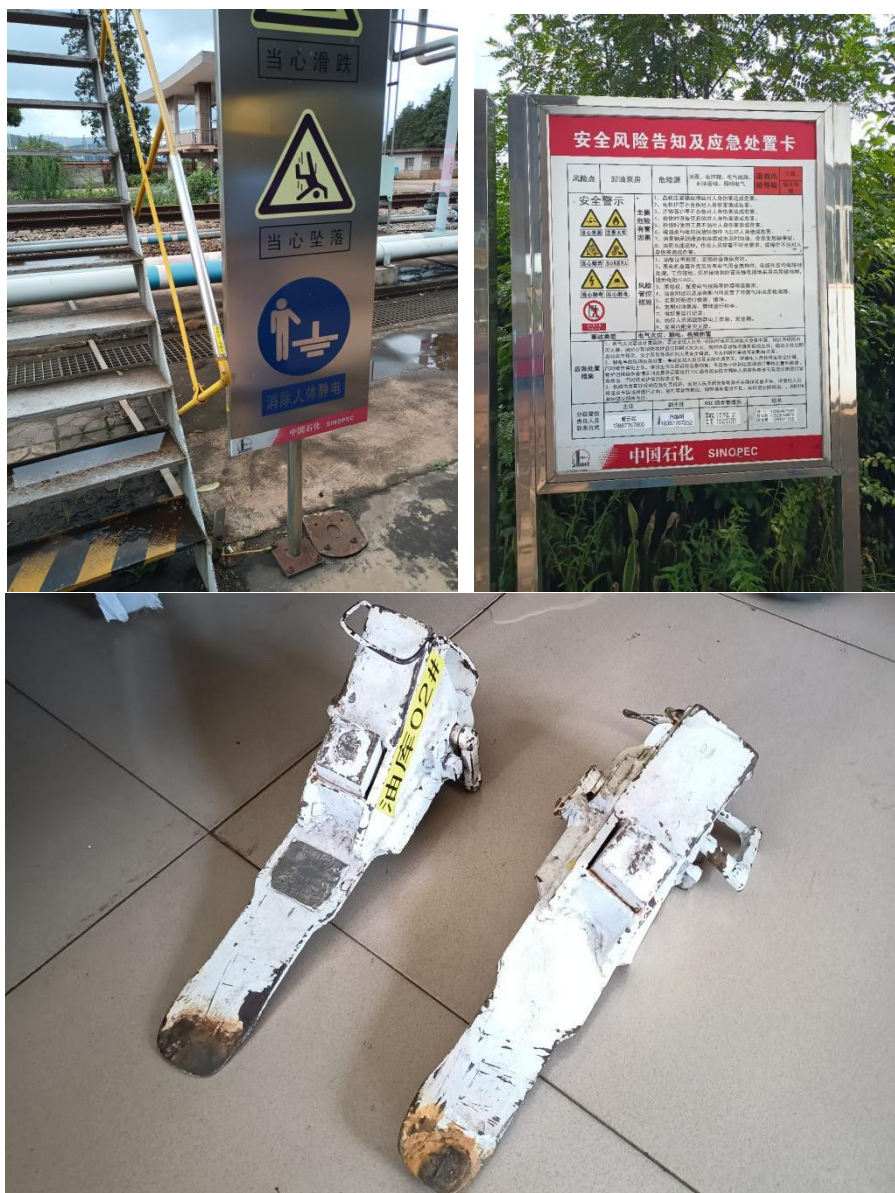
图 2-11 人体静电导除装置、安全警示标示、防溜铁鞋
