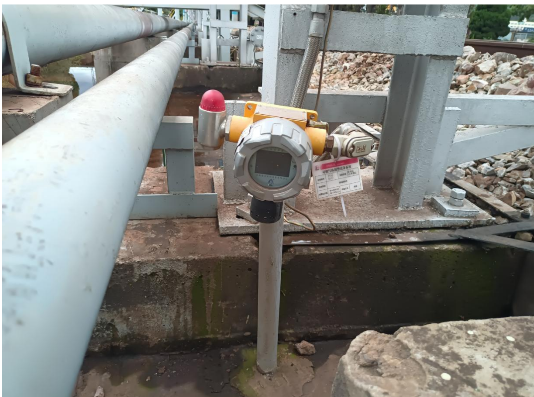
图 2-4 栈桥下方气体检测报警
